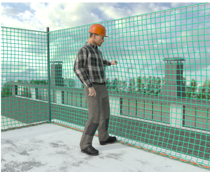
Abbildung 4: Randsicherung auf einer Dachfläche
